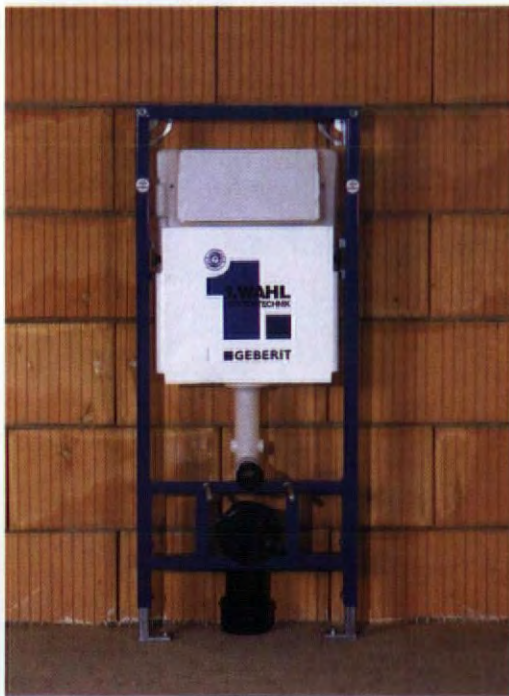
Geberit preWall Installations
