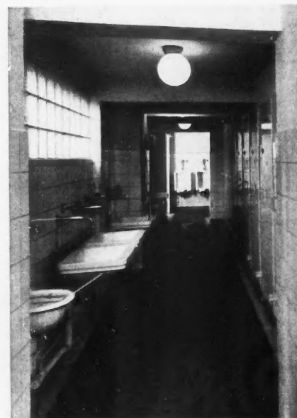
VUE DES SANITAIRES DES ATELIERS. Commandes au pied par boutons spéciaux des lavabos et W.-C. Ventilation par aspiration.
