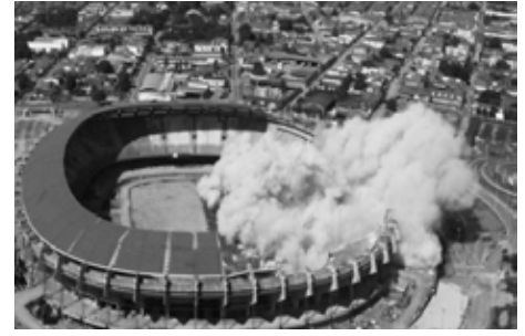
Fig. 5 Figure. 5: Implosion of part of the seating of the Castelão. Source: http://www.parceriaengenharia.com/2012/destaque/sem-reciclagem-lixo-da-copa-de-2014-ira-parar-em-aterros-sanitarios-nas-12-cidades-sede-2/ .
